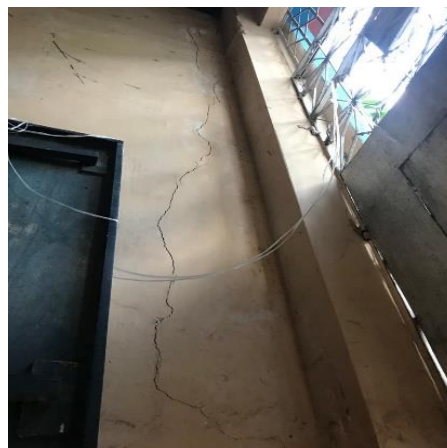
Foto 4 – Parede com rachadura
